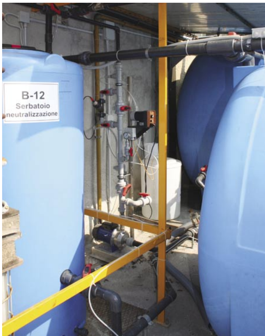
Fig. 13 - Il gruppo di valvole automatiche della neutralizzazione
